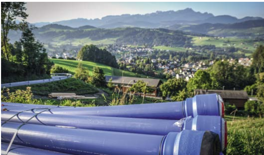
Im Auftrag der Wasserversorgung Teufen werden die Leitungen zwischen Gremm und Schäflisegg erneuert.
