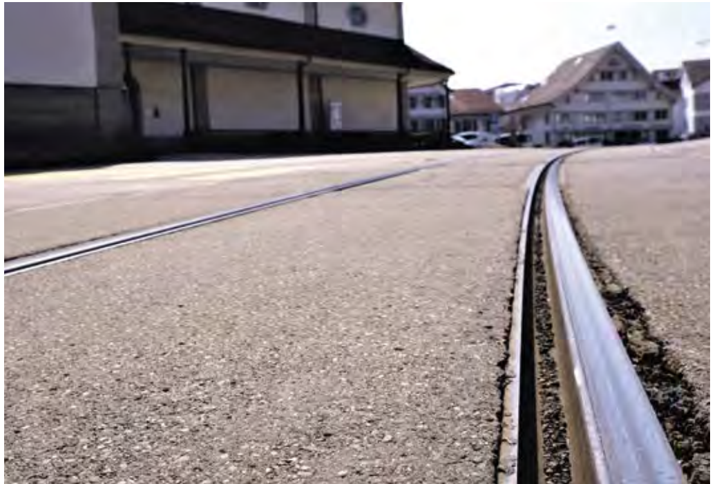
Noch wurde kein praxistaugliches Mittel zum «Füllen» der Schienen gefunden. Foto: tiz
