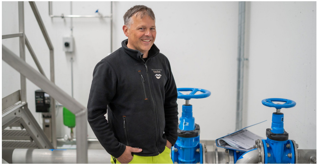
Thomas Oehri, Leiter der Wasserversorgung Teufen, im neuen Reservoir Häuslersegg.. Foto: nek
