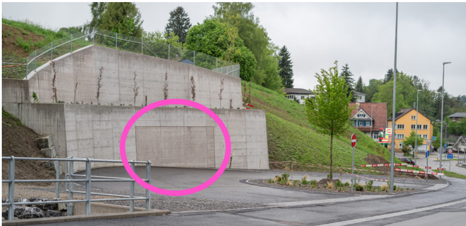
Diese «Aussparung» in der Mauer soll irgendwann in Zukunft die einfachere Erschliessung einer Tiefgarage ermöglichen. Fotos: Archiv
