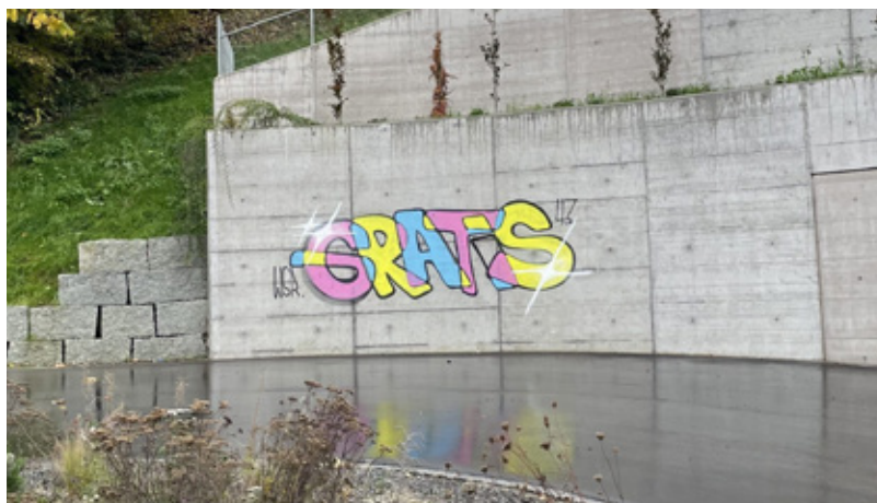
Lange konnte sich das «Gratis»-Graffiti an der Stützmauer nicht halten.
